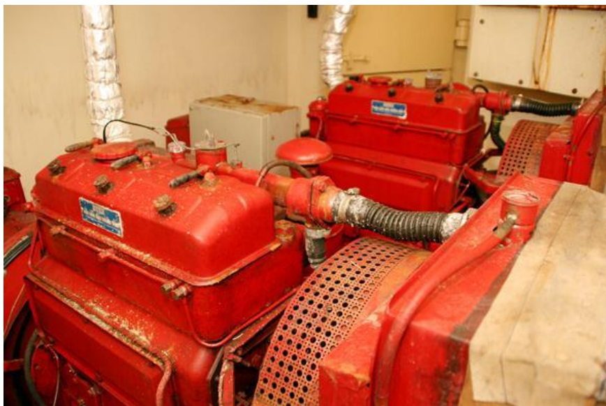
To stk. nødgeneratorer. Foto: Peter Glitten, Frederiksborg Amtsavis 2011.
